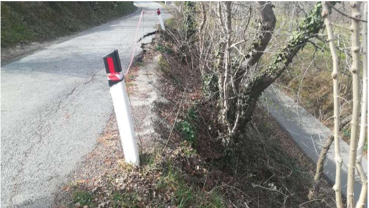
Figura 5 – Vista da monte del tratto di Strada Alliaudo oggetto di intervento per cedimento dell'opera di sostegno stradale di sottoscarpa.
