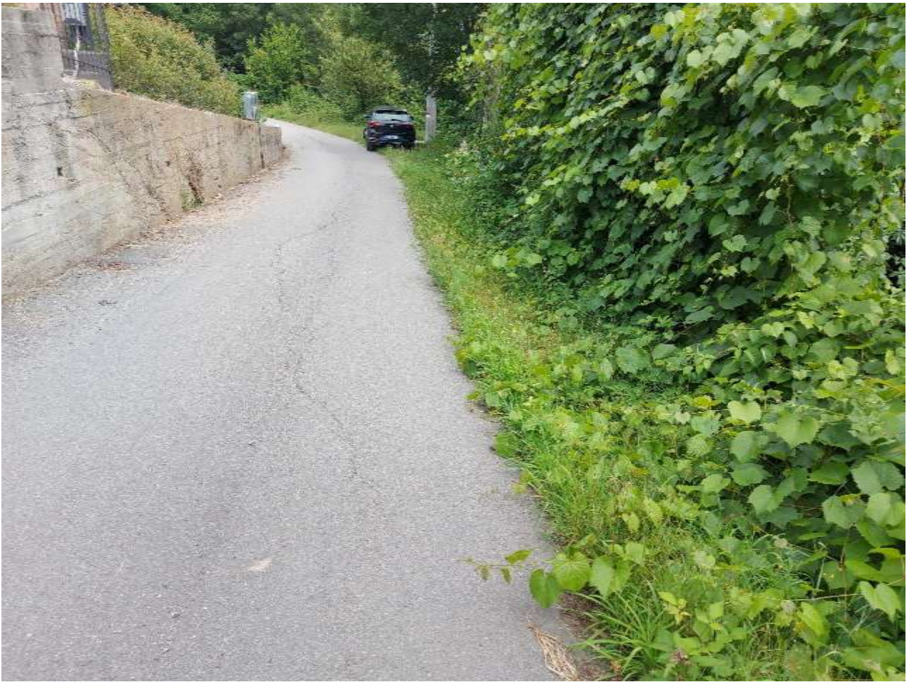
Figura 3 – Vista da monte del tratto di Strada Canavero oggetto di intervento per cedimento di sottoscarpa Vista da
