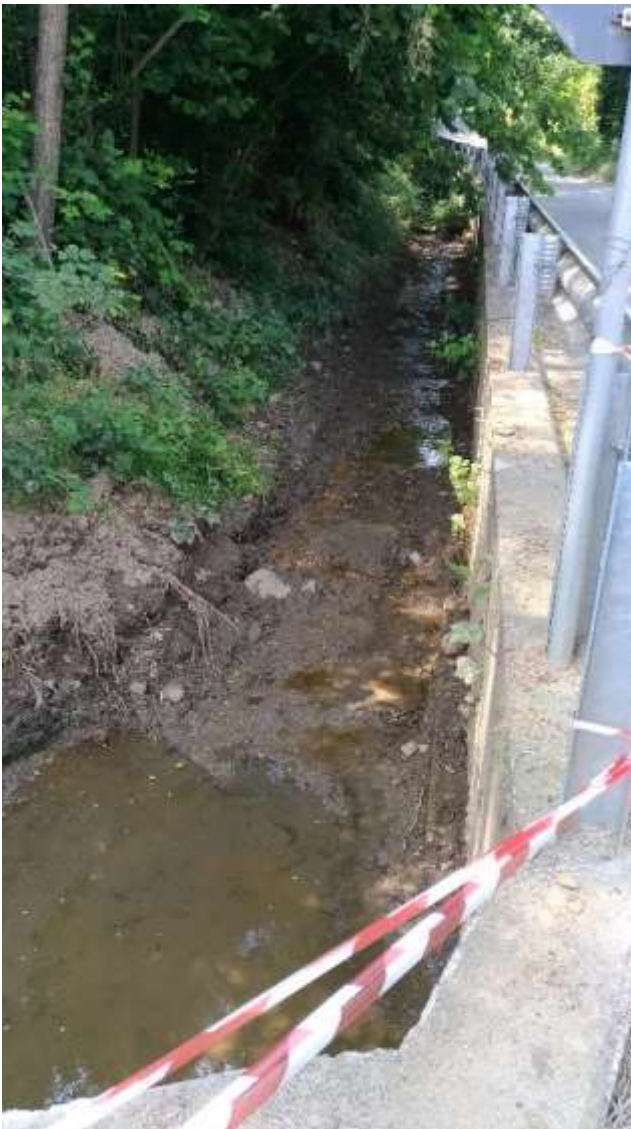
Figura 1 – Intervento lungo la Strada Comunale Cesani Sardegna in corrispondenza dell'incrocio con Strada Comunale Cesani Granero (comune di Bricherasio), in evidenza il tratto di canale di scolo delle acque oggetto di erosione; vista da valle.
