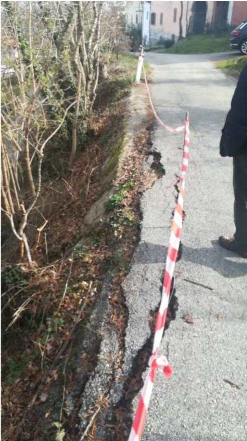
Figura 4 – Intervento su Strada Alliaudo nei pressi di borgata Cesano (comune di Bricherasio), in evidenza il tratto oggetto di cedimenti per il quale si prevedono gli interventi in progetto; vista da valle.
