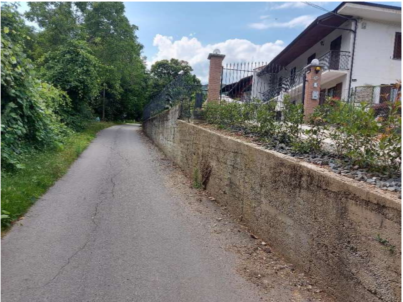
Figura 2 – Intervento localizzato lungo la Strada Comunale in località Canavero (comune di Bricherasio), in evidenza il tratto oggetto di cedimenti per il quale si prevedono gli interventi in progetto; vista da valle
