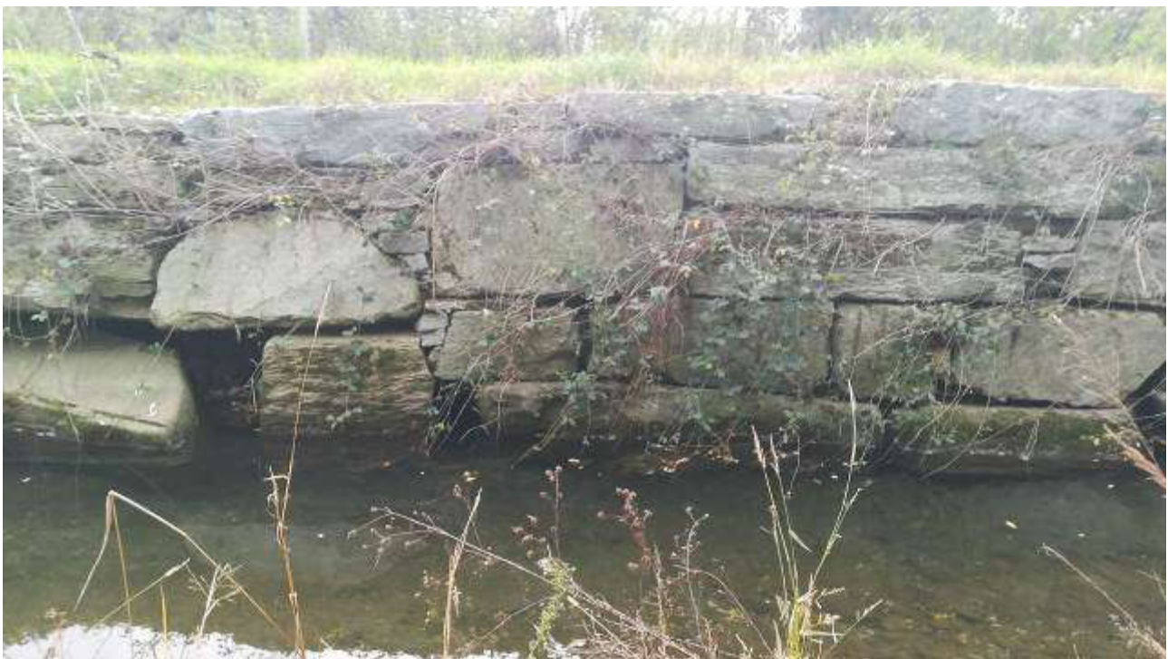
Vista di un tratto di inserimento della massiciata in progetto, a sostegno della scogliera esistente erosa
