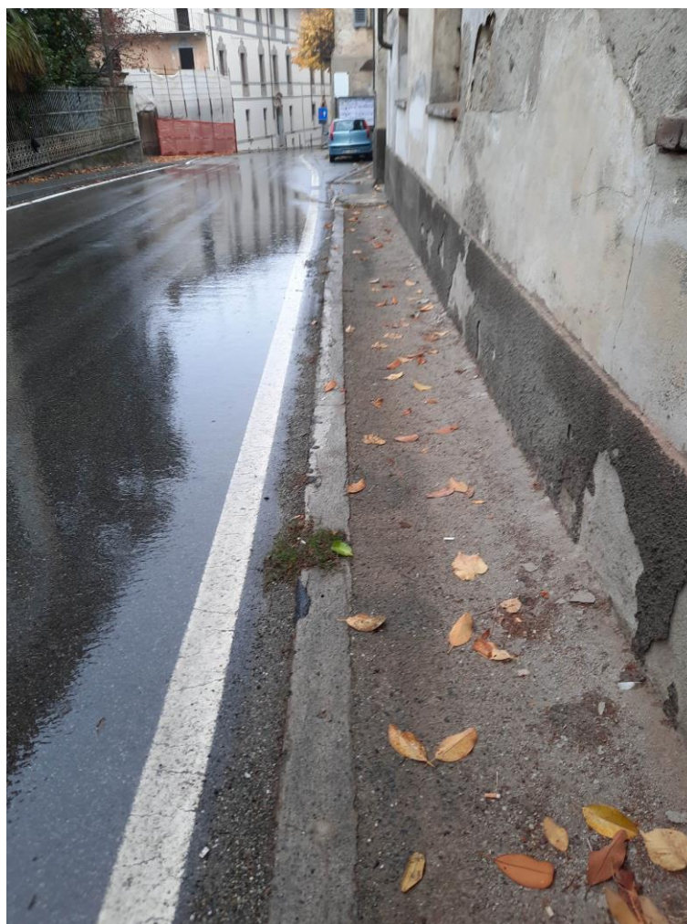
TRATTO DI PASSAGGIO PEDONALE DA RIPRISTINARE
