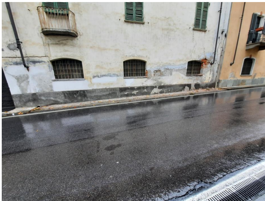
TRATTO DI PASSAGGIO PEDONALE DA RIPRISTINARE
