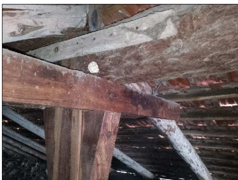
azioni torcenti su elementi di appoggio insufficienza di appoggio del colmo
